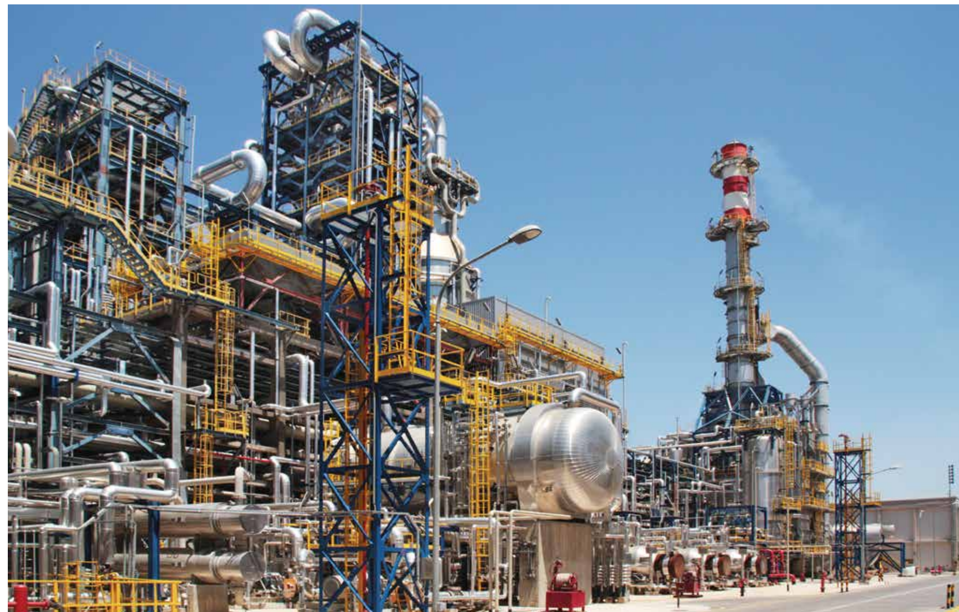
Πύργος & Φούρνος Κενού - Σεπτέμβριος 2012 Vacuum Tower & Vacuum Heater - September 2012
