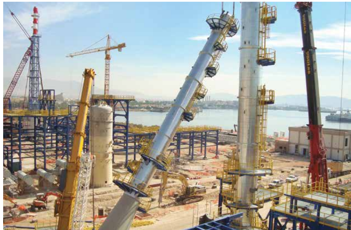
Απογυμνωτής Όξινου Νερού - Σεπτέμβριος 2010 / Οκτώβριος 2012 Sour Water Stripper - September 2010 / October 2012
