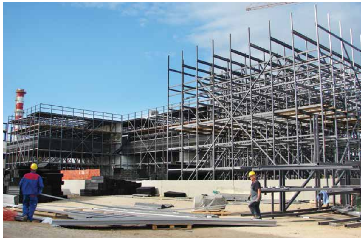
Μονάδα Νερού Ψύξης - Νοέμβριος 2010 / Οκτώβριος 2012
