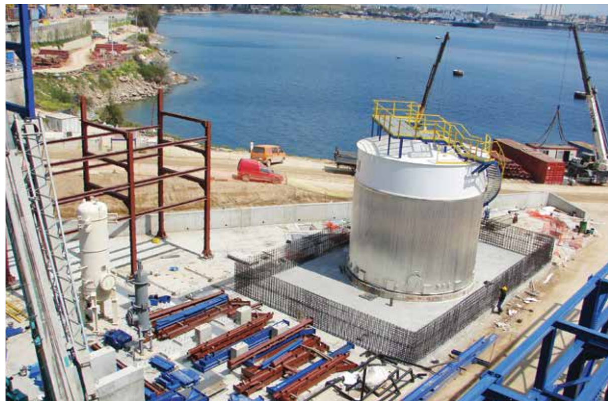
Μονάδες Υγρών & Αέριων Καυσίμων - Απρίλιος 2011 / Οκτώβριος 2012 Liquid Fuel & Fuel Gas Unit - April 2011 / October 2012
