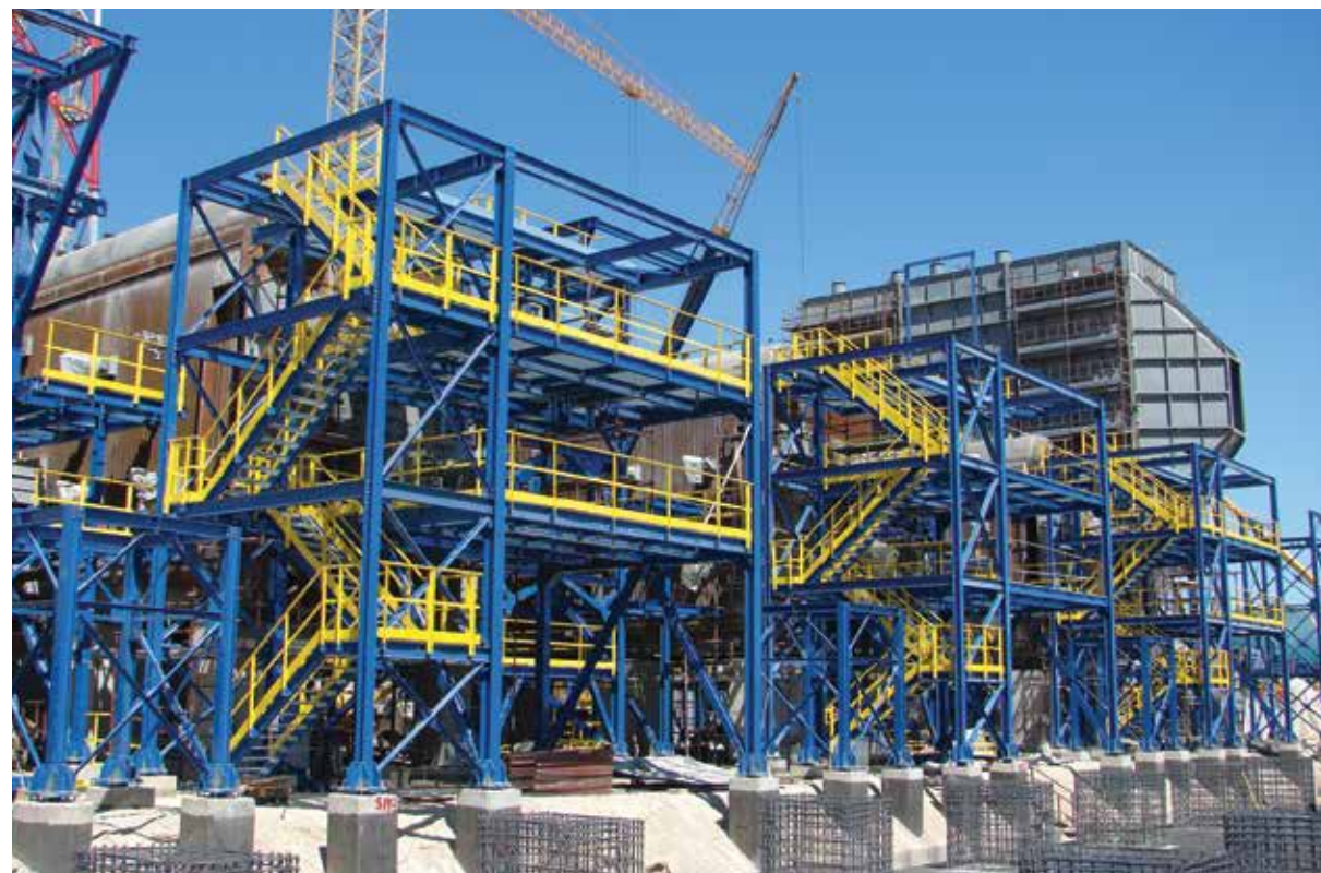
Μονάδα Παραγωγής Ατμού - Σεπτέμβριος 2010 / Οκτώβριος 2012 Steam Generation Unit - September 2010 / October 2012
