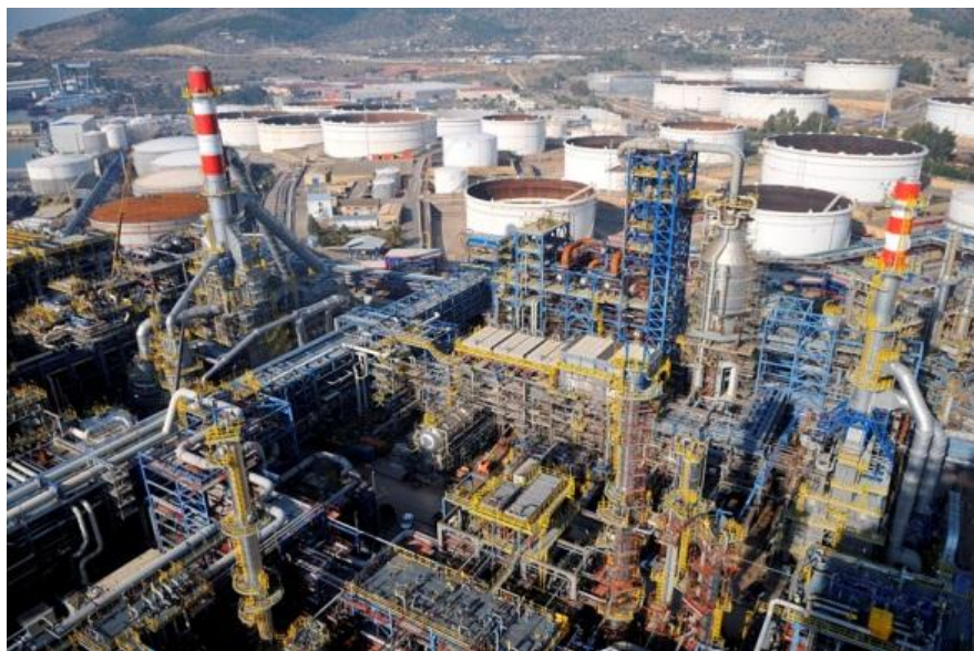
Μονάδες υδρογονοπυρόλυσης (hydrocracker) και αργού
