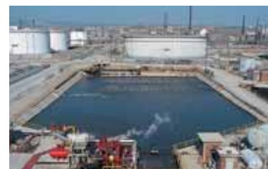
Κατεργασία υγρών αποβλήτων
