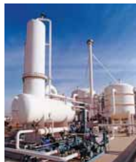
Μονάδα Ανάκτησης Ατμών στις φορτώσεις βυτίων
