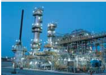
Μονάδα Υπεραποθείωσης Ντίζελ
