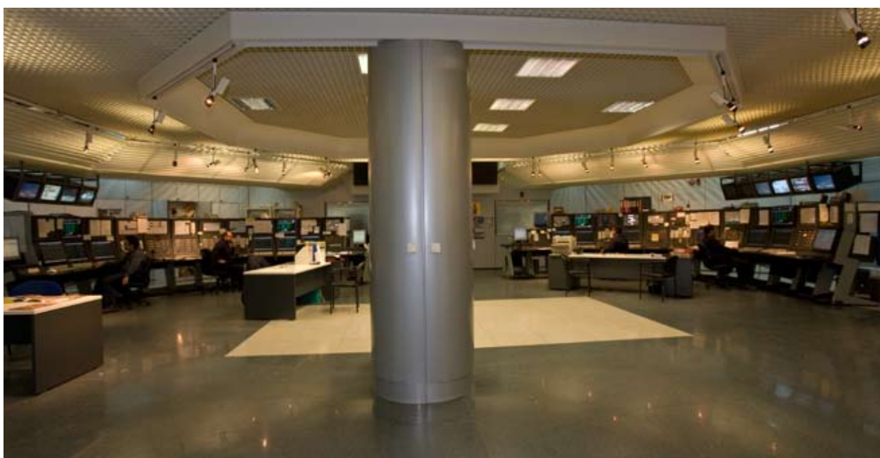
Κέντρο Ελέγχου του Διυλιστηρίου Θεσσαλονίκης
