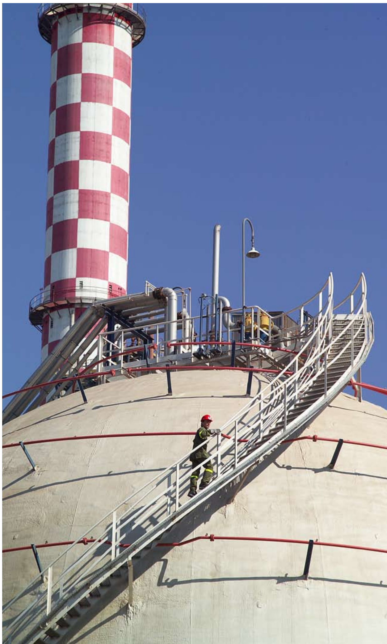
Δεξαμενή Αποθήκευσης Προϊόντος στις ΒΕΑ
