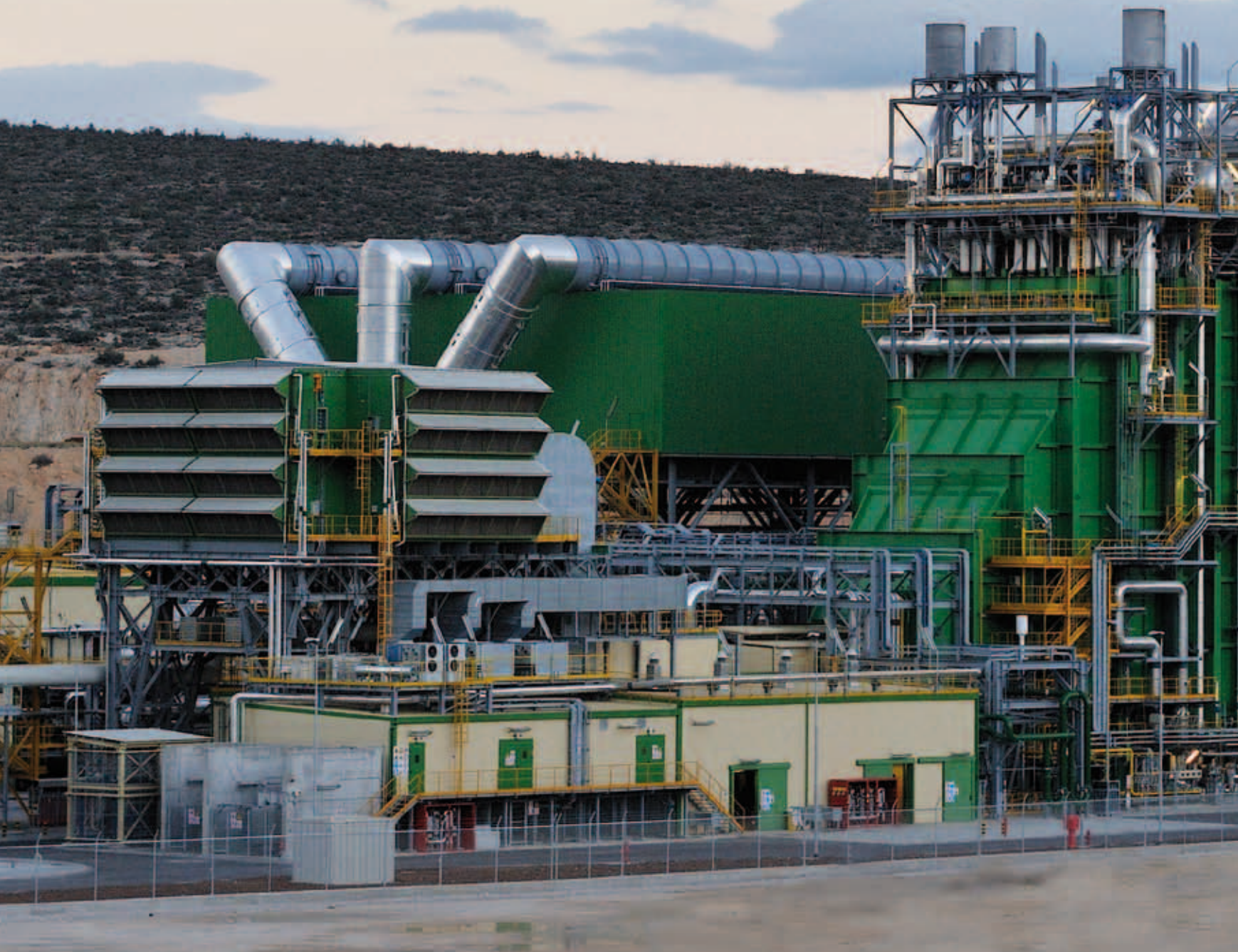
Μονάδα Παραγωγής Ηλεκτρικής Ενέργειας στη Θίσβη Βοιωτίας
