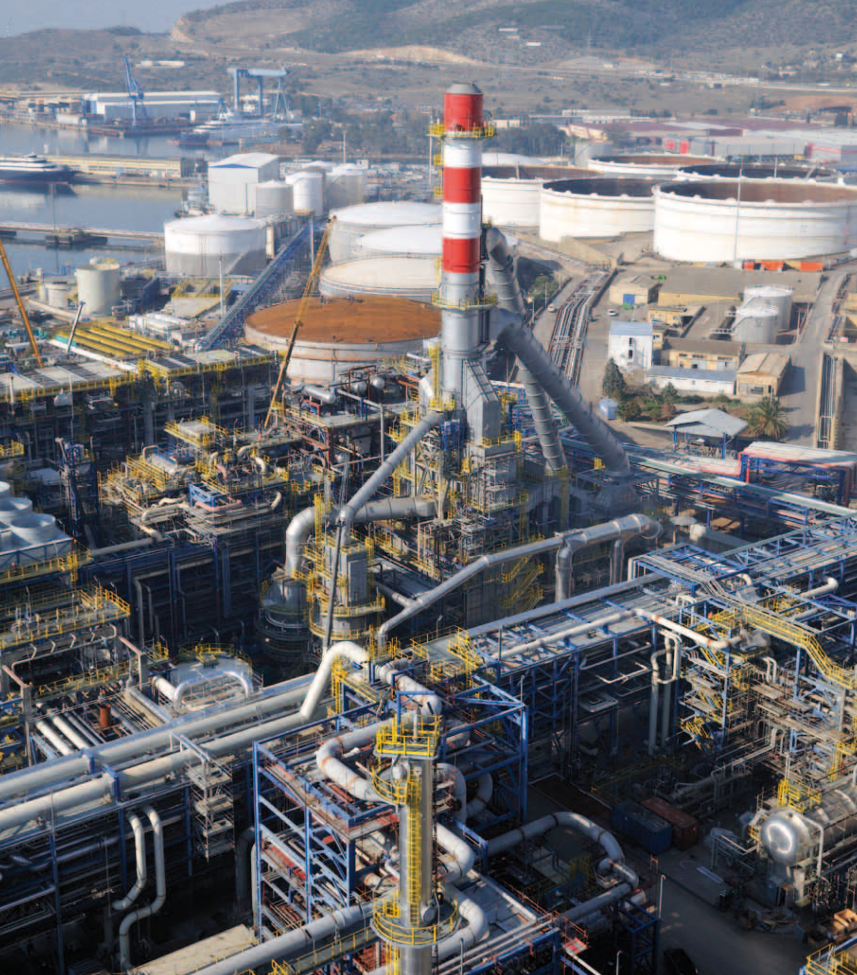
Unit-34 - Συγκρότημα Φούρνων & Αντιδραστήρες Καταλυτικής Υδρογονοπυρόλυσης Διυλιστηρίου Ελευσίνας
