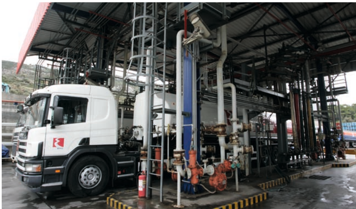
Σταθμός φόρτωσης διυλιστηρίου Ασπροπύργου
